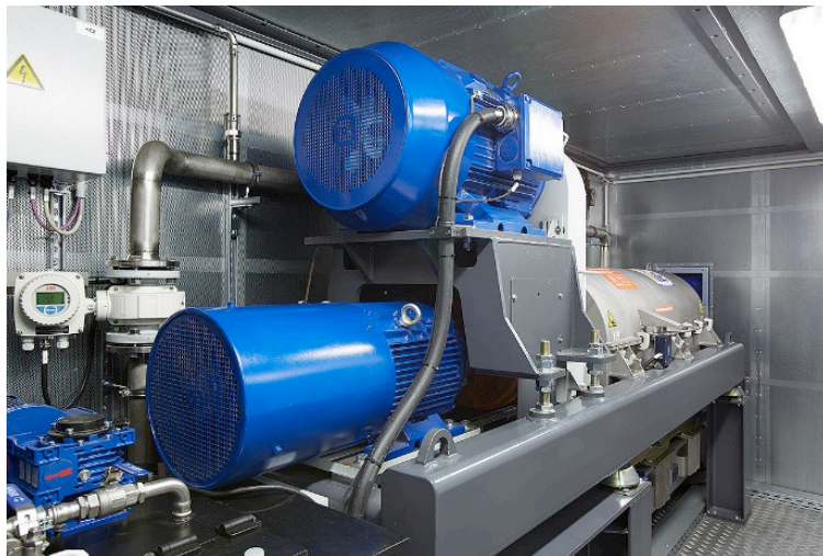
Dekanterzentrifuge der mobile Dekanteranlage ZR15046
