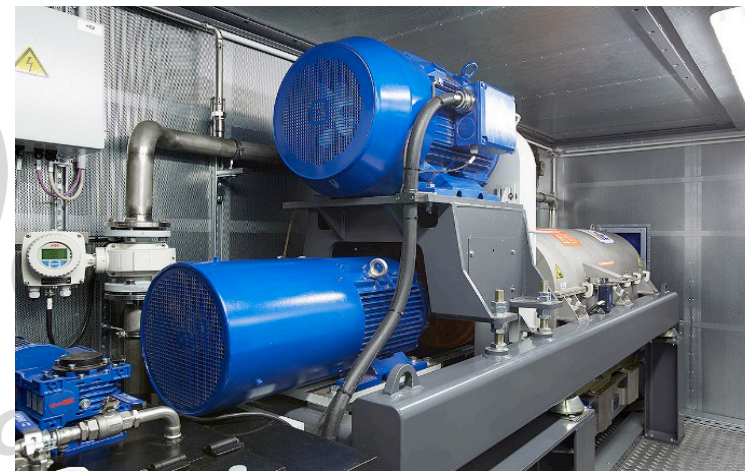
DSE Dekanteranlage ZR15046 / ZR17254
